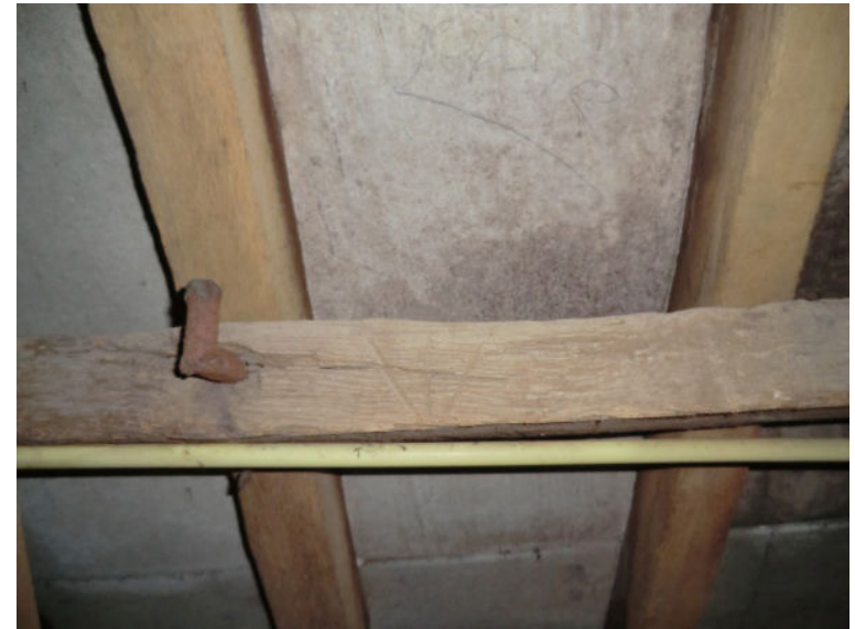
Kapconstructie achterhuis: gehaald timmermansmerk wurmt westelijke dakhelft
