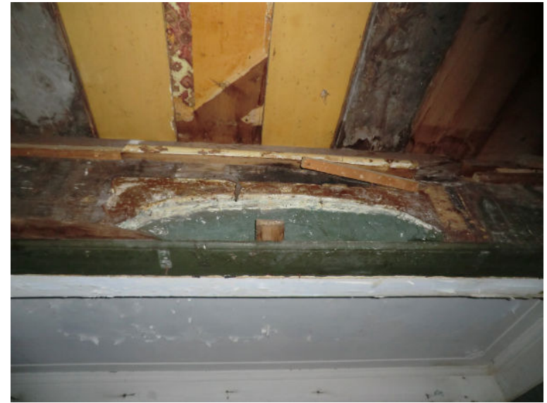
Bouwdeel A, begane grond: inkeping voor oud trapgat in eiken balk
