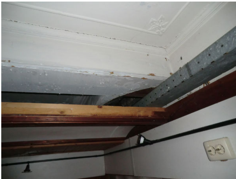
Bouwdeel A, begane grond: stucplafond, raveling en aftekening boezem
