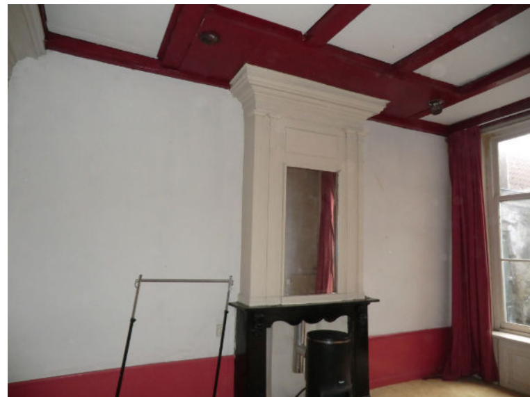
Begane grond: westwand achterkamer met schouw en boezem onder grotere raveling
