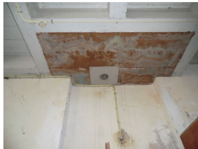
Bouwdeel C: begane grond met raveling van grote oorspronkelijke haardsteen
